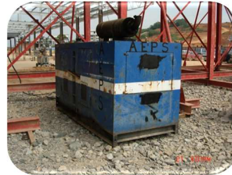
3. Genset kapasitas 100 KVA
